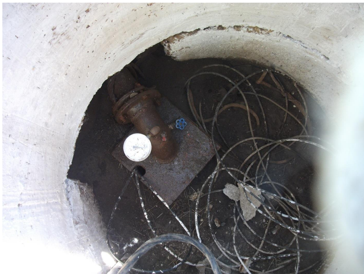
Скважина водоснабжения с. Лопатино.
